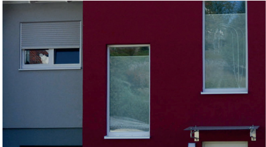
Modernisierungs- und Instandsetzungsbedürftiges Gebäude mit geringem Bedarf
