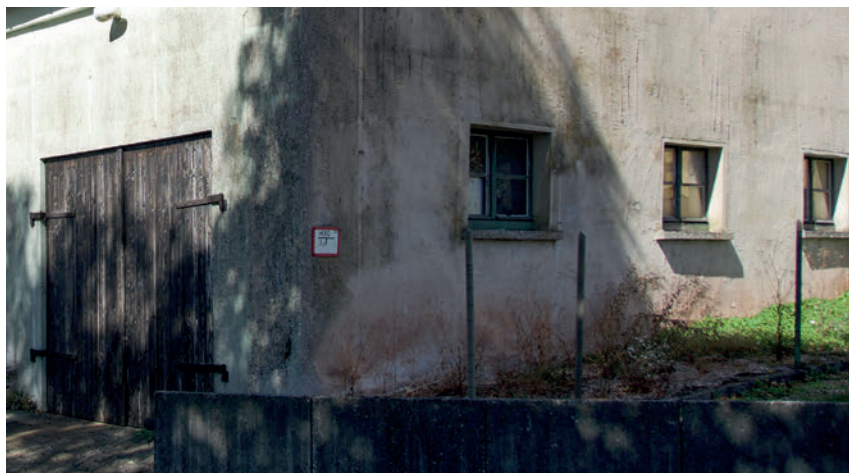
Modernisierungs- und instandsetzungsbedürftiges Gebäude mit hohem Bedarf
