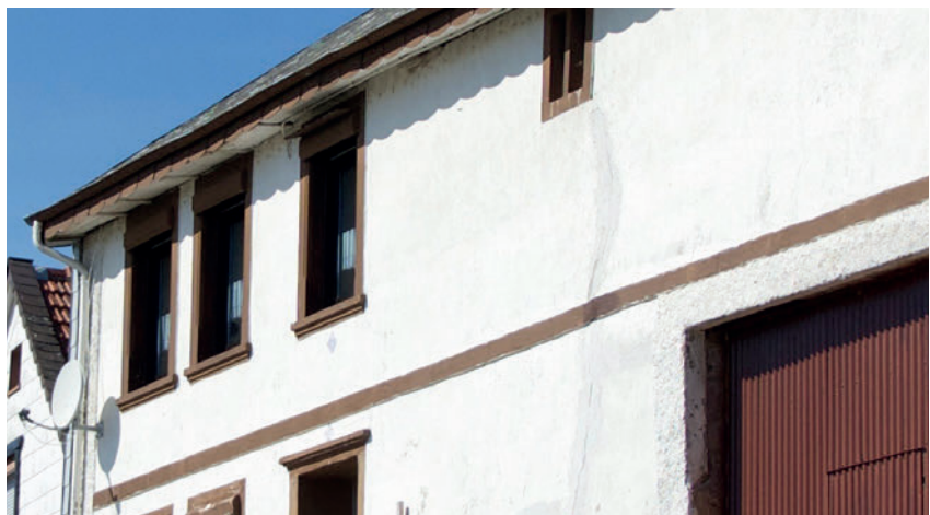
Modernisierungs- und instandsetzungsbedürftiges Gebäude mit mittlerem Bedarf
