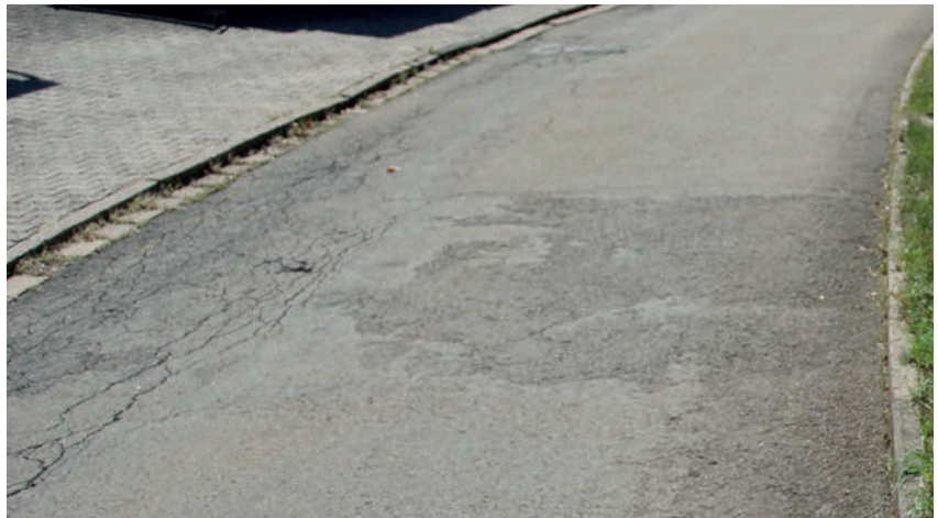
Sanierungsbedürftige Fahrbahndecke der Deckenhardter Straße
